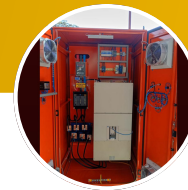
Fabricación, reparación y mantenimiento de tablero de arranque por variador de velocidad, arrancadores suaves y todo tipo de arranque de centro de control de motores
