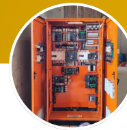
Fabricación de tableros de transferencia y tableros de distribución
