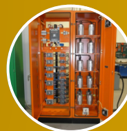
Calidad de energía y banco de condensadores
