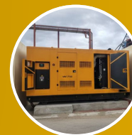
Mantenimiento y reparación y puesta en servicio de grupos electrógenos
